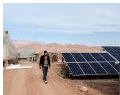
شکل ۲- نصب پنل‌های خورشیدی روی سقف یا کنار گلخانه
