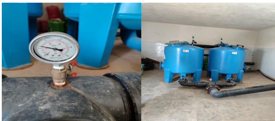
شکل ۳- اندازه گیری اختلاف فشار بین فیلترها در اتاقک کنترل مرکزی
