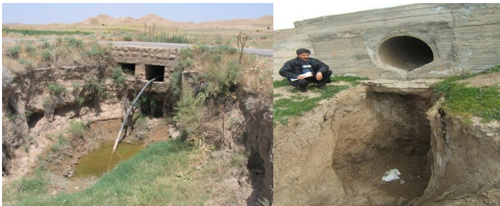
شکل ۲- ساخت غیراصولی آبگذرهای جاده‌ای در مغان اردبیل (سمت راست) و هلویش لرستان (سمت چپ)
