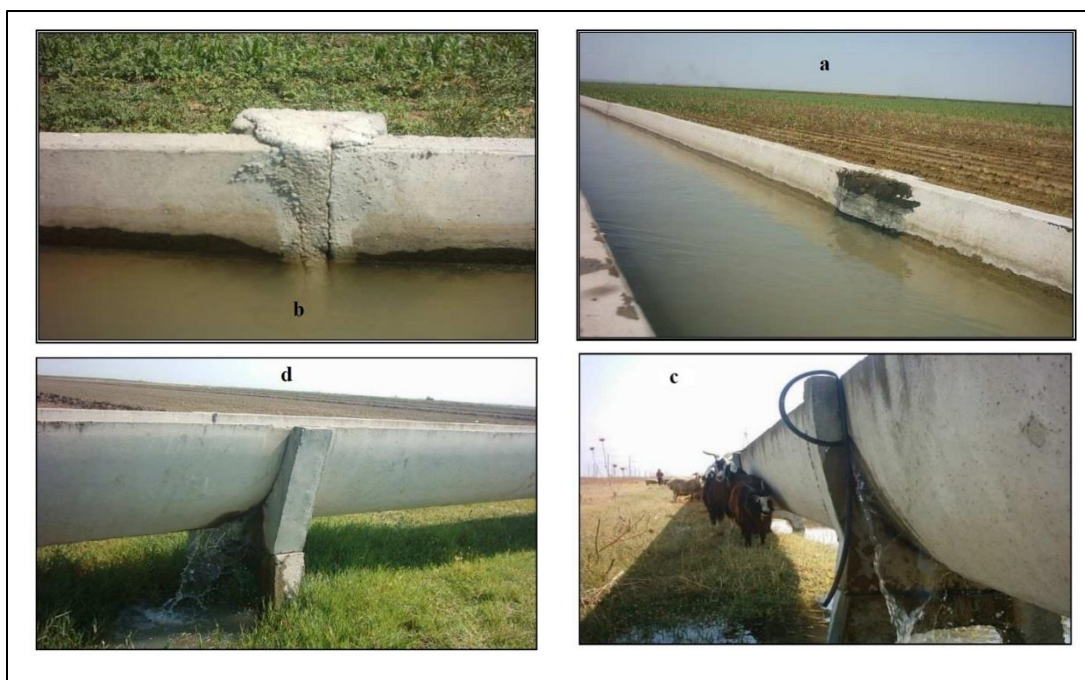
شکل ۴- آب‌بندی غیراصولی اجراشده (a و b) و تخریب واشر آب‌بندی و نشت آب از آن (c و d)
